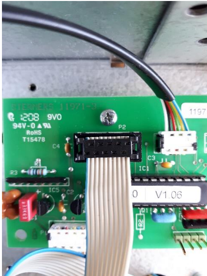
Bild 1 , myntboxens kretskort. Befintlig bandkabel dras ut.
