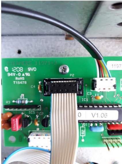
Bild 1 , myntboxens kretskort. Befintlig bandkabel dras ut.
